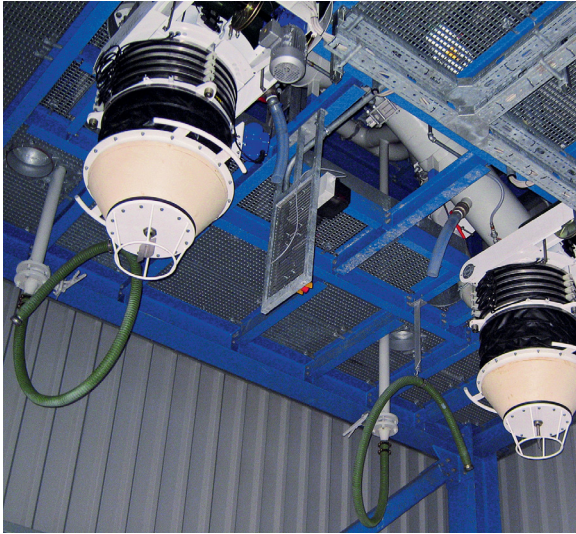
Diese Doppelverladestation für staubförmige Baustoffe ist mit dem Drehflügel-Füllstandanzeiger DF22 mit Vibrationsdämpfung ausgestattet
