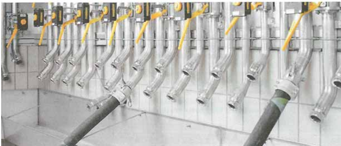
Mit den kodierten Kupplungen ist auch in den größten Schlauchbahnhöfen eine mögliche Verwechslung ausgeschlossen
