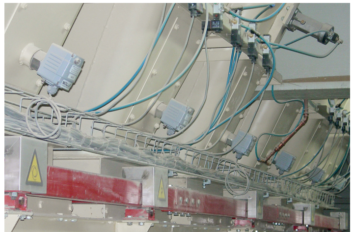
Abb. 1: Der Füllstand dieser Komponentenzellen in einem Mischfutterwerk wird mit dem Drehflügel-Füllstandanzeiger DF21 überwacht.
